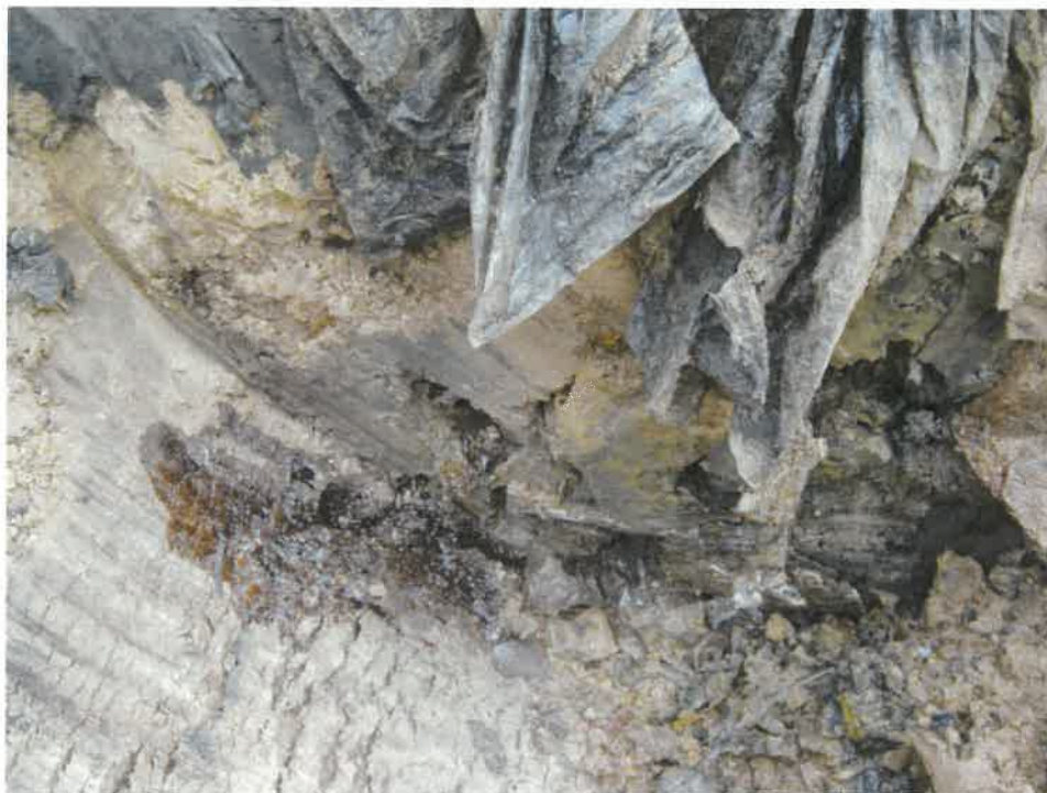
Photographie 24 : exemple de suintement observé lors de l'excavation de la zone SC
