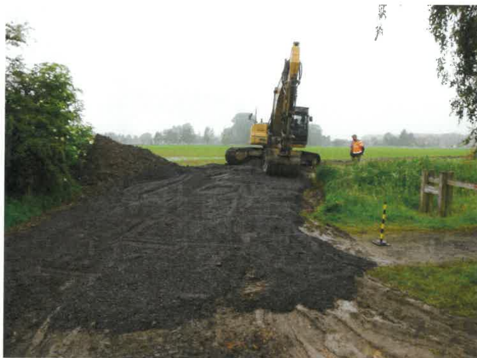
Photographie 53 : Mise en place de cailloutis calcaire pour permettre la circulation sur la rampe d'accès
