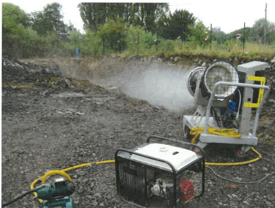
Photographie 21 : système de brumisation et de neutralisation des odeurs
