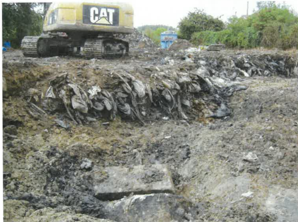
Photographie 15: fond d'excavation de la zone B - front de la zone A
